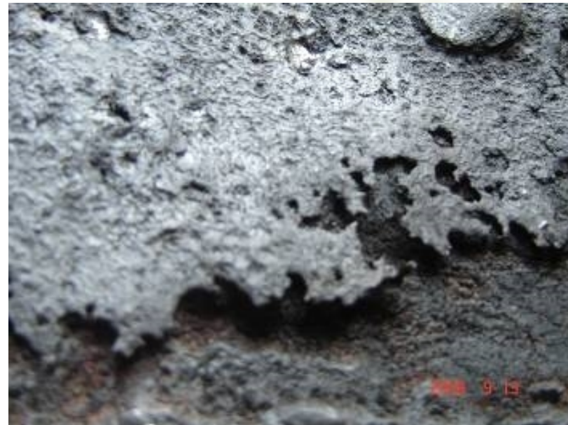
减三线段塔壁贴板腐蚀状况
