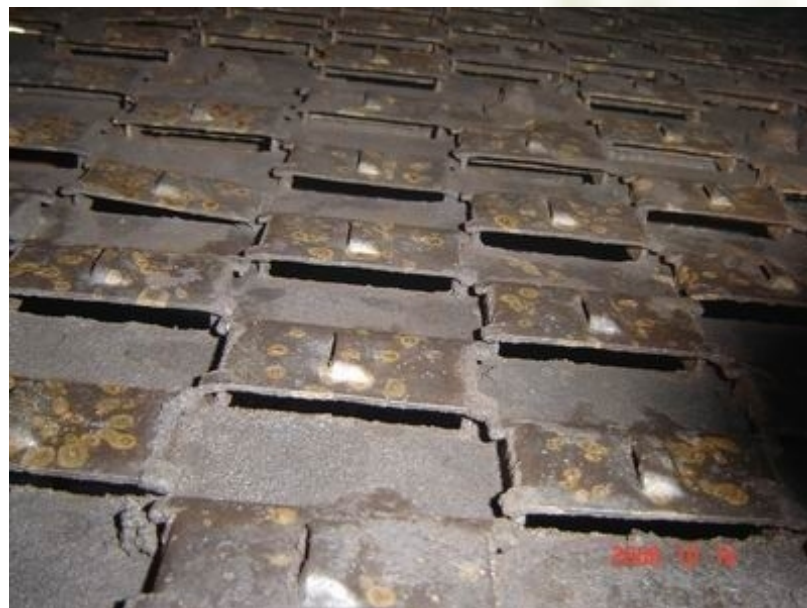
某炼油厂常顶浮阀点蚀形状
