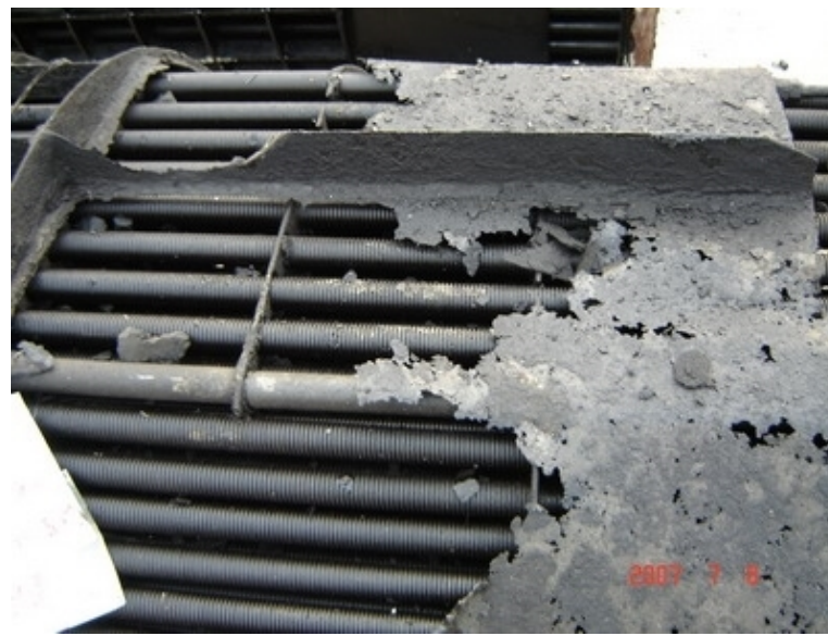
初底油-减渣换热器防冲板腐蚀情况
