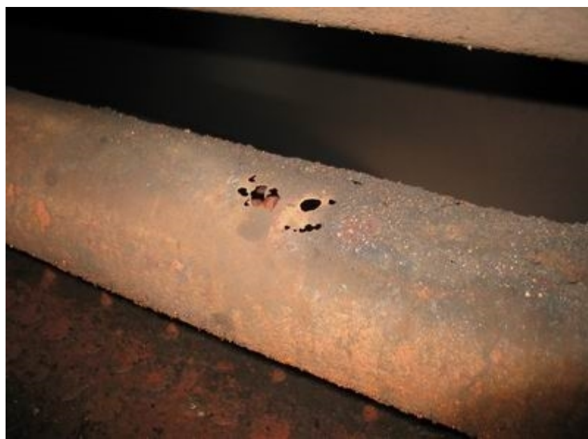
常顶回流管腐蚀穿孔
