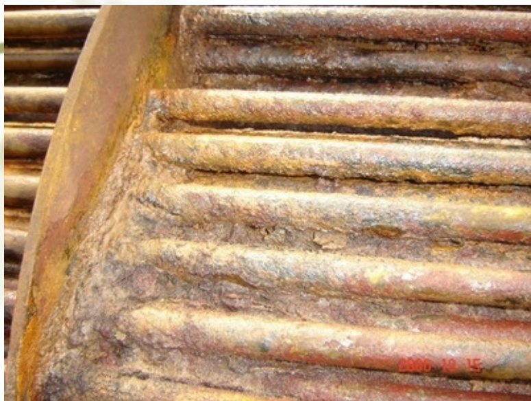
常顶油气换热器管束结垢及腐蚀形态
