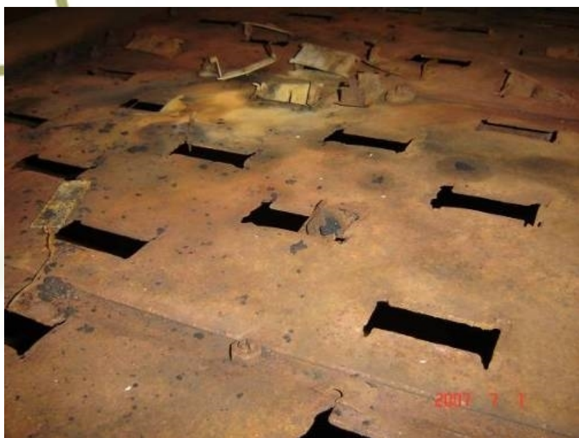
常压塔塔顶塔盘腐蚀
