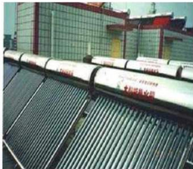
太阳能 热水器 是典型的利用 辐射换热 原理
