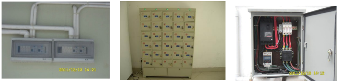
图 6.2.3-2 36 伏变压器及强弱电控制开关、集中充电管理、时间继电器
