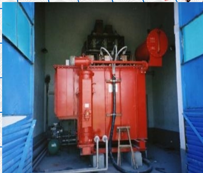
静电除尘器升压变压器
