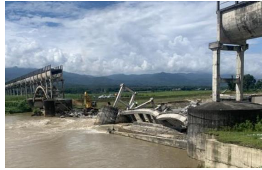
图 1.2 麻栗坝水库渡槽垮塌事件
