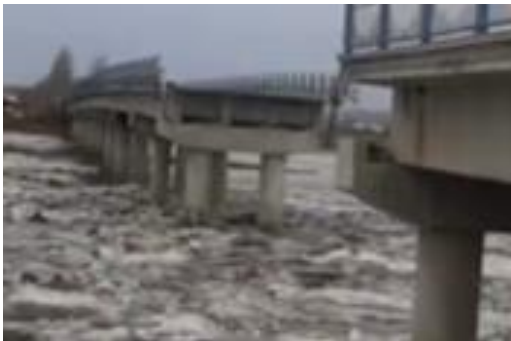
图 1.3 哈尔滨方正县新兴大桥垮塌事件
