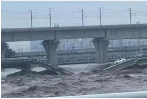
图 1.1 北京市小清河桥垮塌事件
