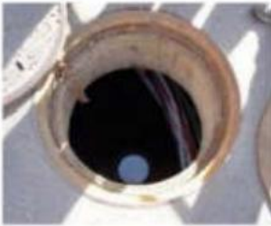
(d) 电力电缆井
