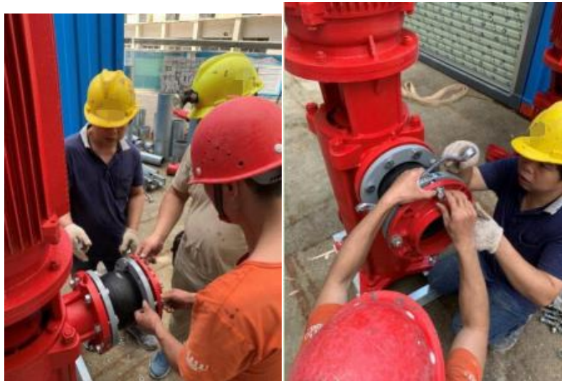
图5. 2. 5-8 模块化泵组现场交底及安装图
