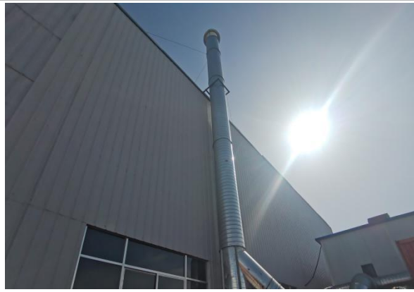
项目喷漆废气排气筒
