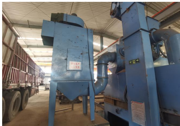
项目抛丸工序布袋除尘器
