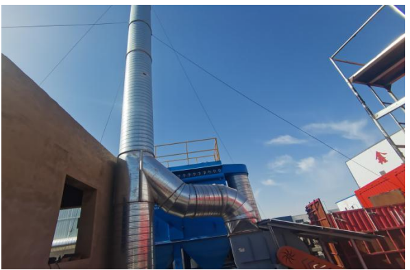
喷砂废气排气筒
