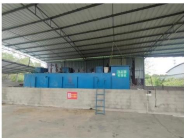
项目污水处理站
