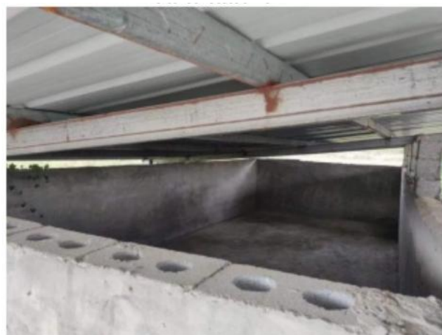
项目事故应急池
