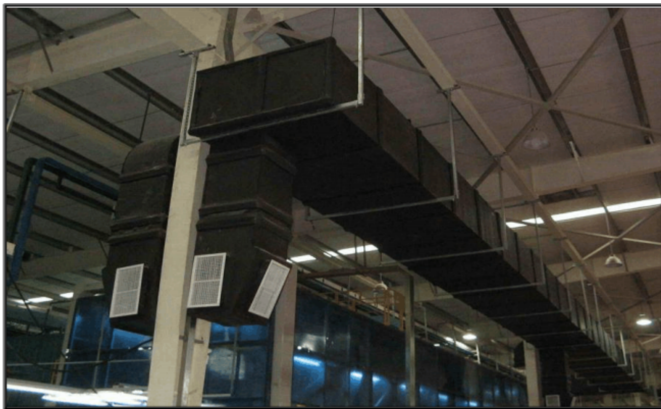
风管安装实例图
