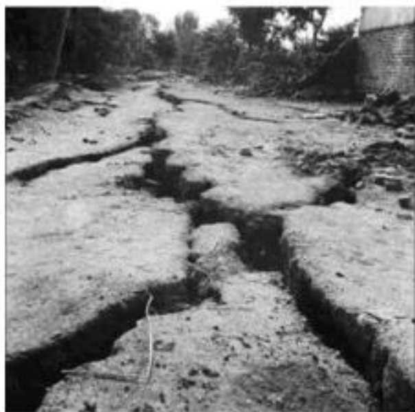
图10.1 地震形成的地裂缝
