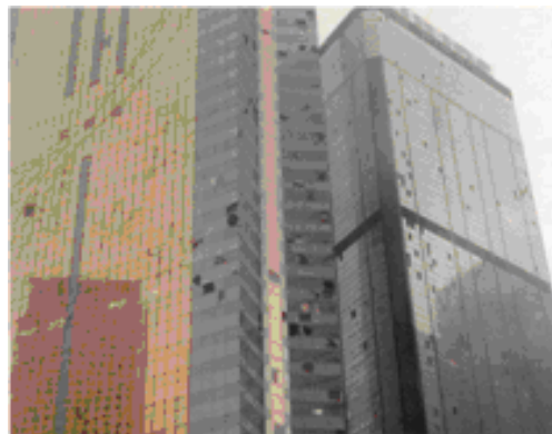
图10.11 高层建筑幕墙破坏
