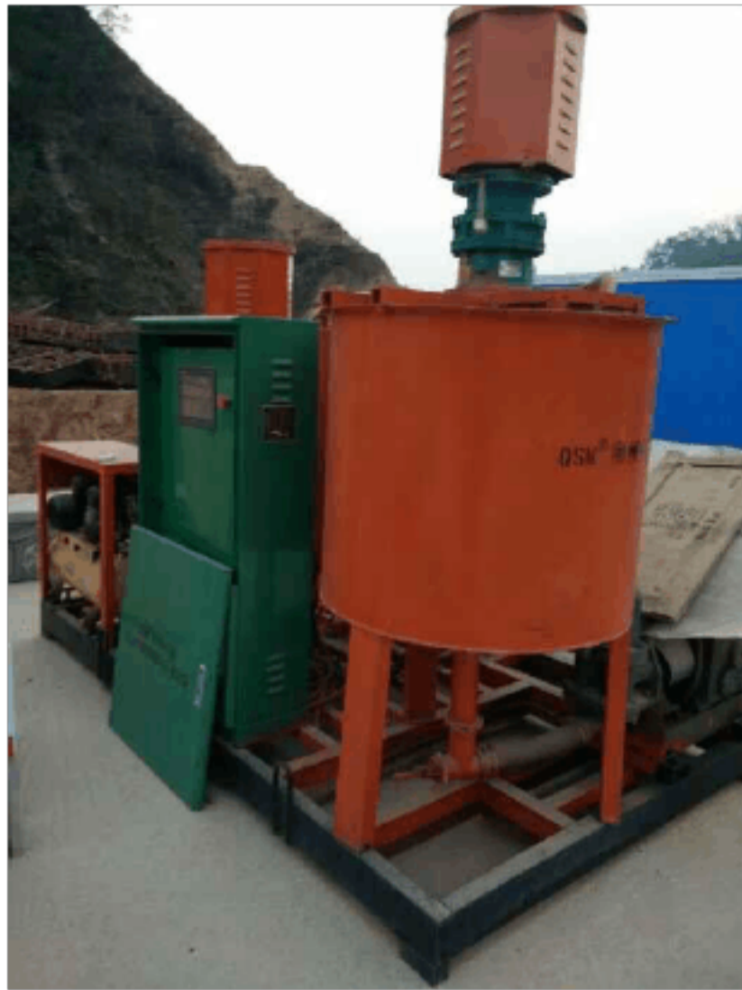
智能孔道压浆系统
