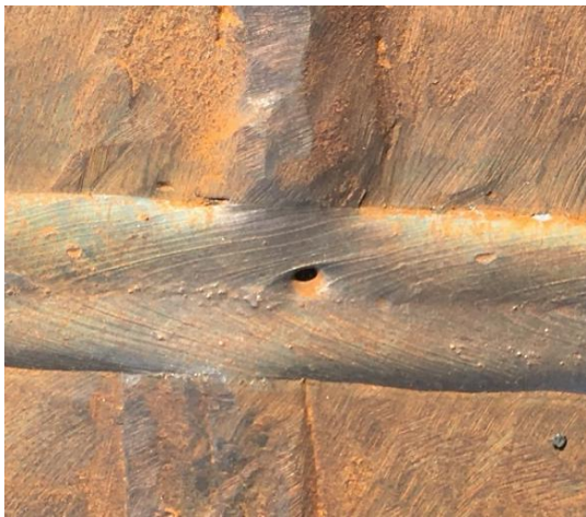
焊缝局部出现的气孔
