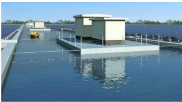
现有项目逆变升压设备
