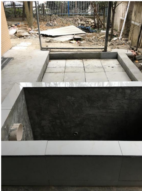
已建污水处理池+毒性废水收集处理池
