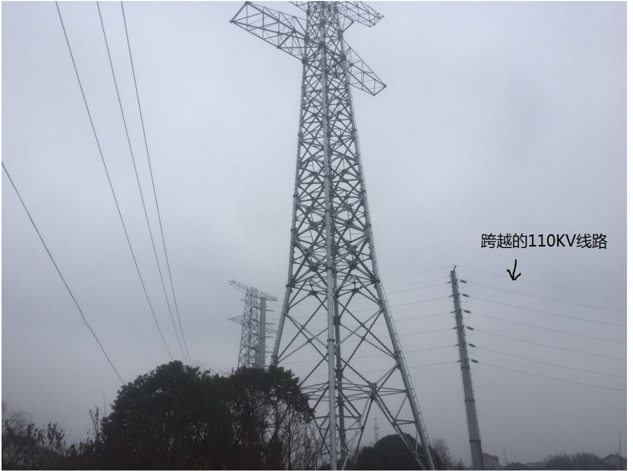
现场实物照片
