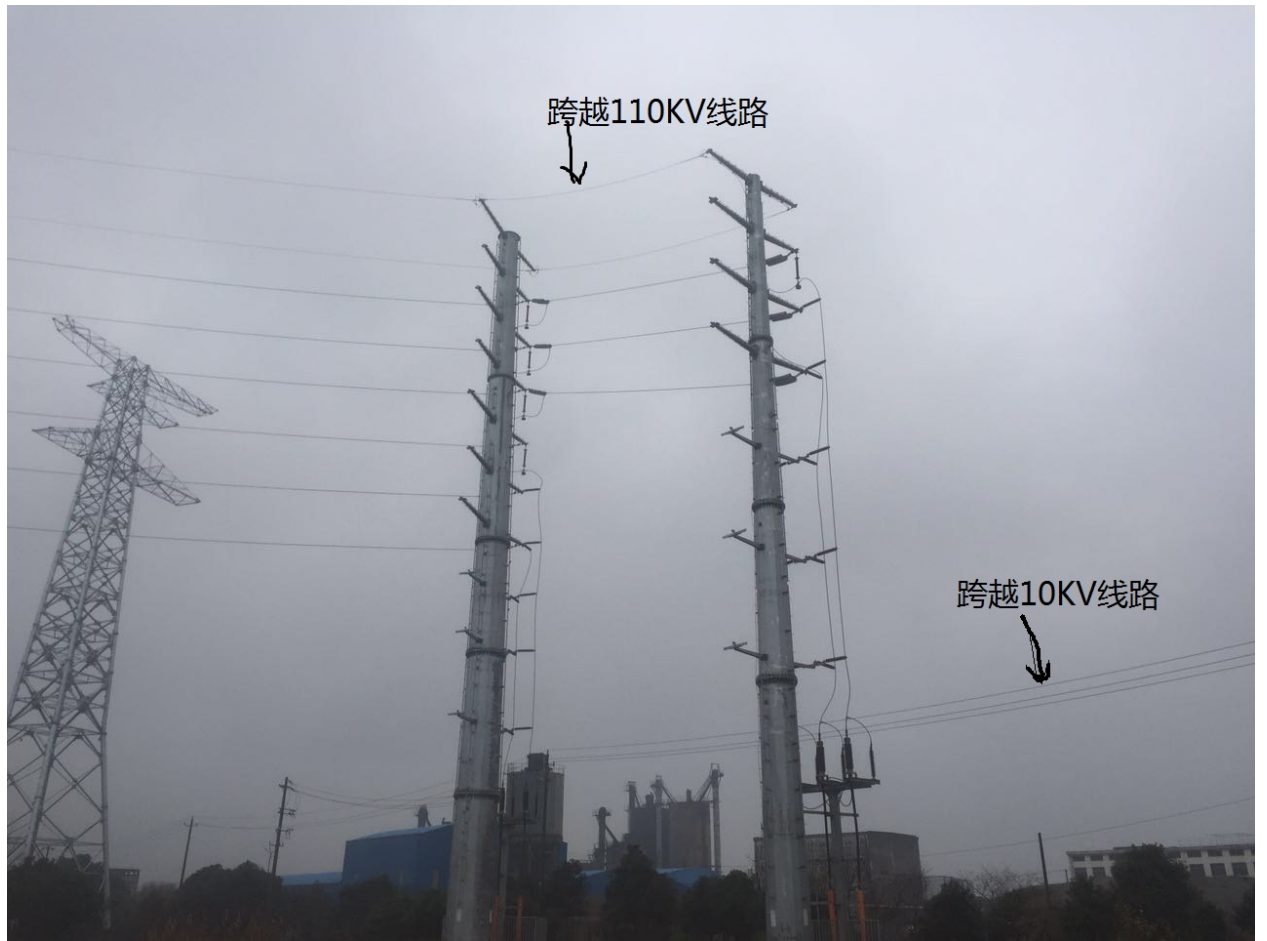
现场实物照片
