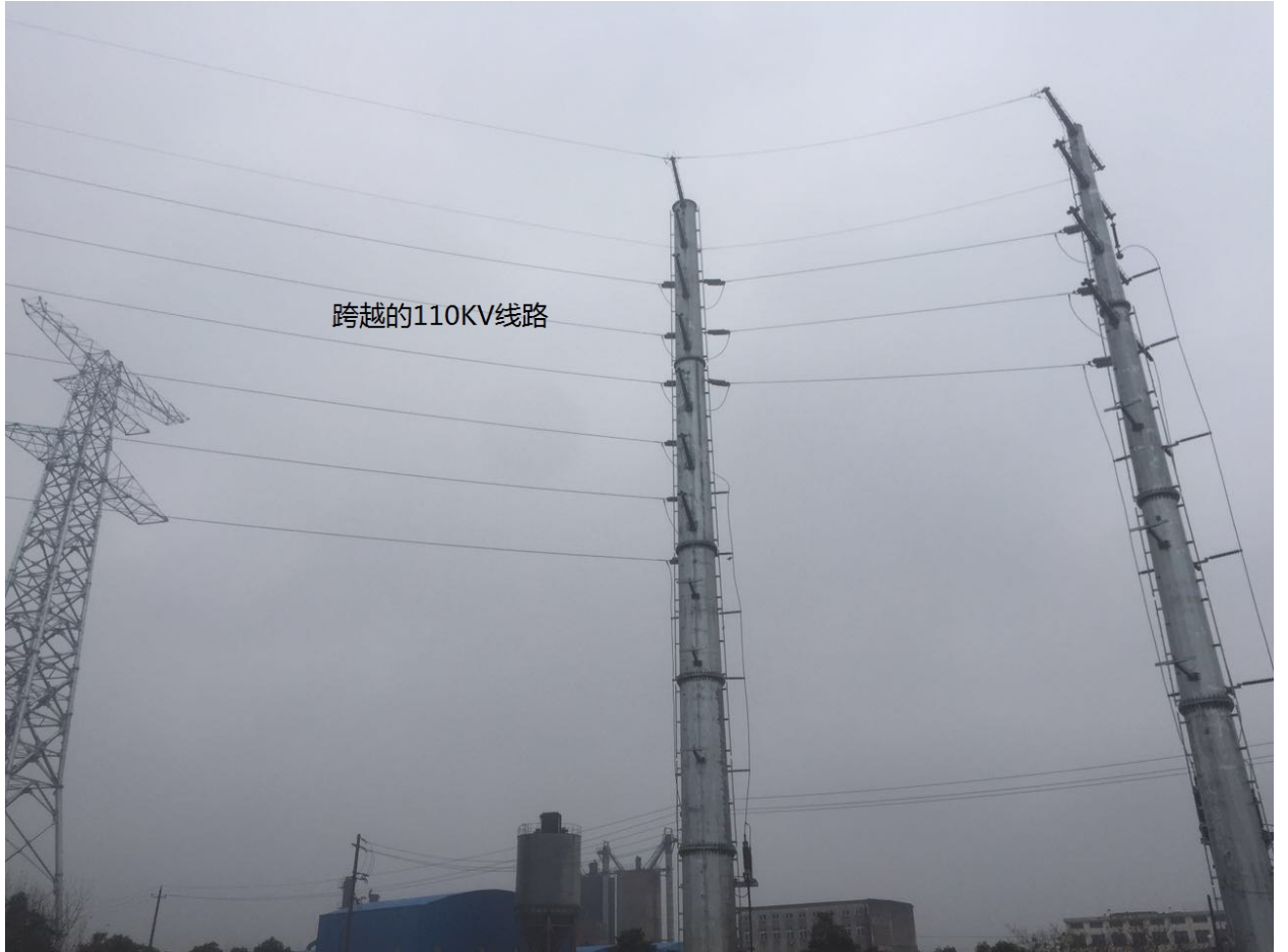
现场实物照片
